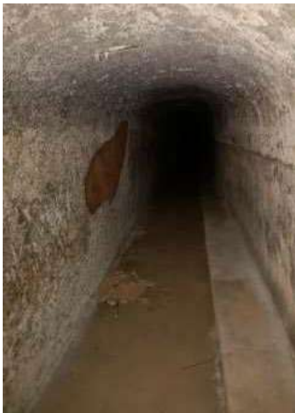
Detall dels sistemes de ventilació excavats a la Roca
